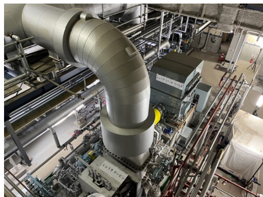
蒸気タービン。排熱を蒸気に変換して発電する装置は巨大！電気の3割は施設内で利用し、残りは売却する。
